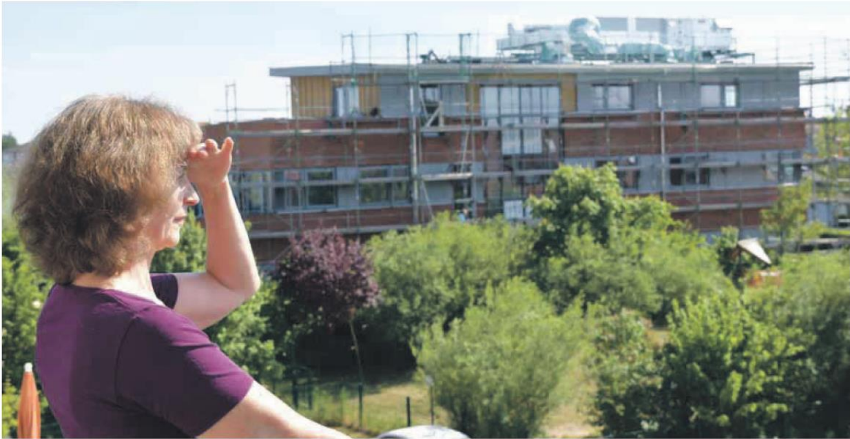
Jutta Strietzel wohnt im Lüneburger Viertel Teufelsküche an der Straße Vor der Heide. Jetzt wird ihr Blick vom Balkon getrübt. Die Belüftungsanlage auf dem Lüwobau-Gebäude wirkt riesig, sie und andere Nachbarn glauben zudem, dass sie auch eine Menge Lärm machen dürfte, wenn sie erstmal in Betrieb ist. Foto: be
