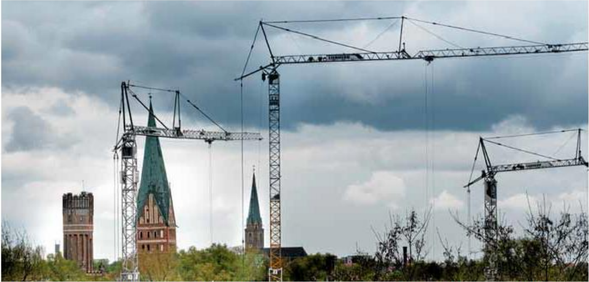
Gebaut wurde zuletzt viel in Lüneburg, bezahlbarer Wohnraum dabei jedoch eher selten geschaffen. Mit einer Kreissiedlungsgesellschaft wollte der Kreis das Problem lösen, doch fand die Idee nur wenig Anklang. Foto: t&w
